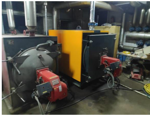
Figura 4-1 Pajisjet e gjenerimit të nxehtësisë - nënstacioni termike i ngrohjes qendrore; kaldaja
